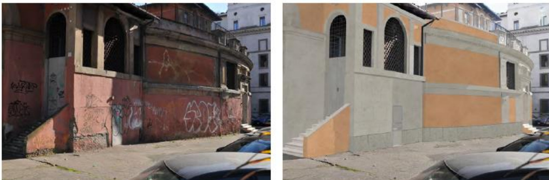
Confronto di dettaglio tra lo stato attuale della facciata su via del Mastro e la simulazione fotografica dopo il restauro
